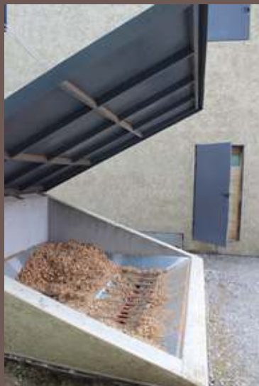
Silo hors-sol. Livraison de plaquettes par bennage, silo alimenté par une trémie de remplissage
