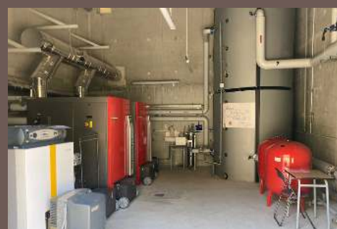
Intérieur de la chaufferie
