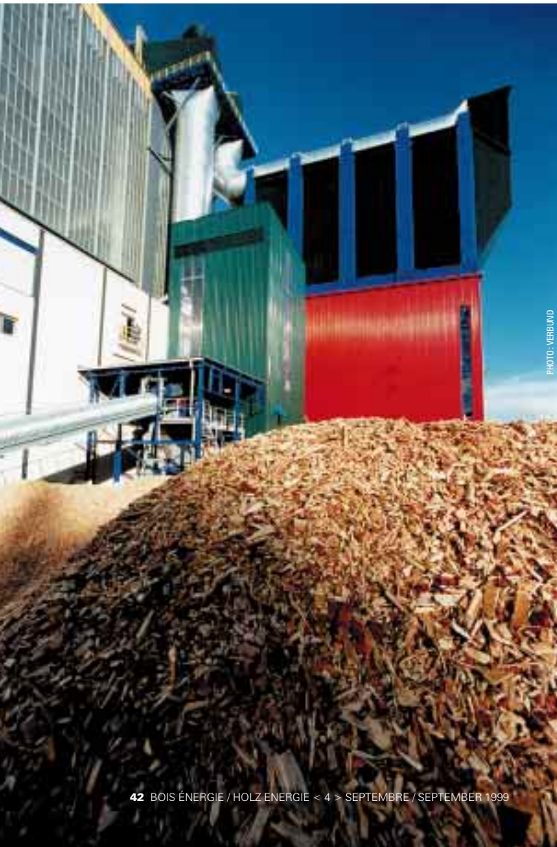
Bild 4: Teilansicht des Dampfkraftwerkes Zeltweg mit Biomasse-Vergasungsanlage.
