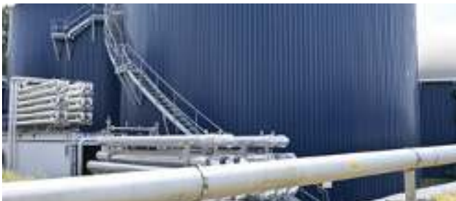
Site de méthanisation à Château-Gontier (53)
