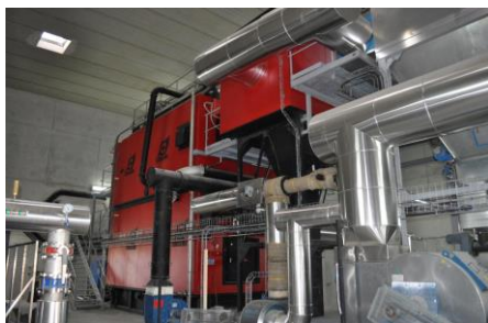
Chaudière de 6 MW
