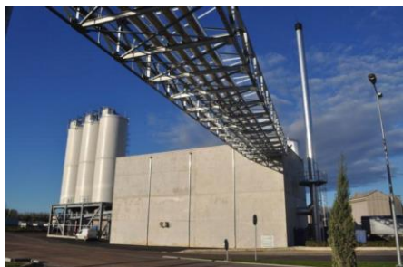
Boisseaux de biocombustible chaufferie et tuyauteries d'eau chaude sur rack
