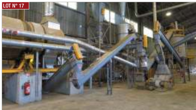
► By-Pass, vis de transfert , buffer 7 m³ produit sec, épierreur, affineur, transport pneumatique, ventilateur du TP, trémie de presse et divers équipements ► By-Pass, Screw, Buffer 7 m³ dry product, Stoner, Refiner, Pneumatic transport, TP fan, press hopper and various equipment
