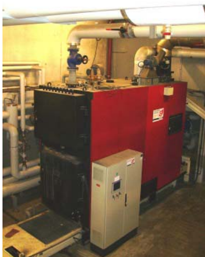
La chaudière Compte de 1,2 MW
