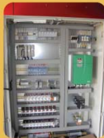
L'armoire de commande
