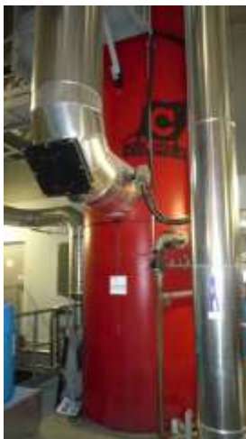
Avec le condenseur sur les fumées, le gain de rendement de la chaudière peut atteindre 10 %.
