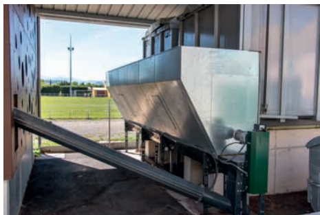
Trémie et vis sans fin amenant le combustible du silo-benne à la chaufferie
