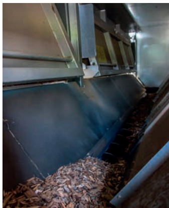
Intérieur de la trémie où se déverse le combustible du silo-benne
