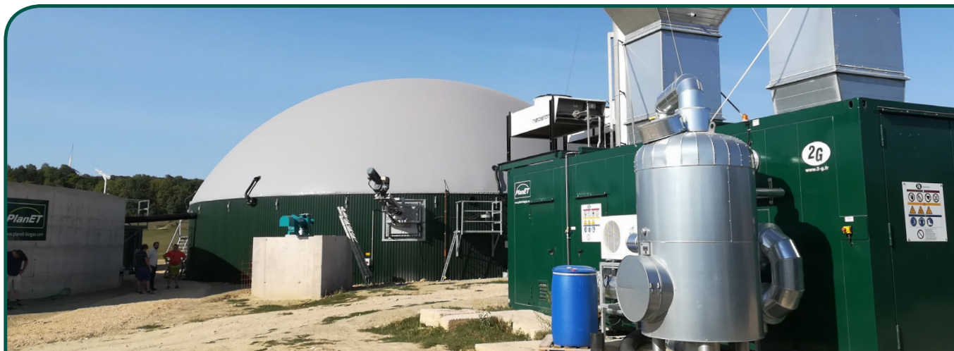
Taille de l'installation: 250 kW | Mise en service: Mai 2018
