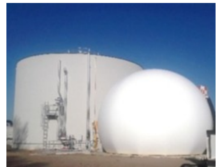
Digesteur et gazomètre
