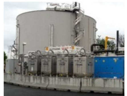
Epurateur et digesteur
