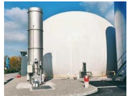
Le gazomètre et la torchère, à côté du digesteur (bleu)
