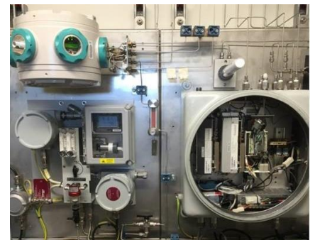
Intérieur du poste d'injection
