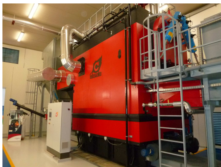
La chaudière bois de 2,9 MW
