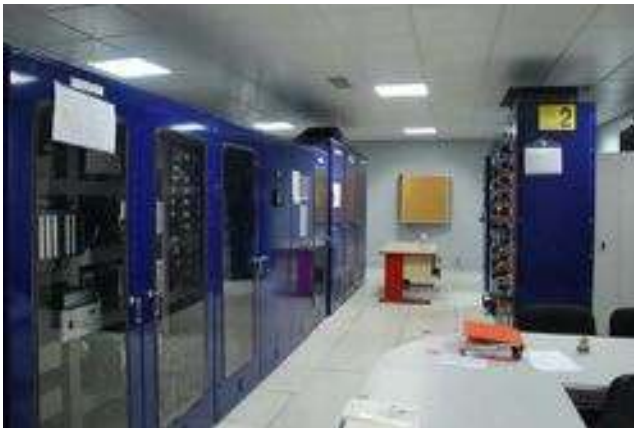
Salle de contrôle commande
