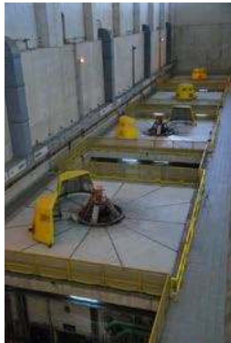
4 groupes blocs de production
