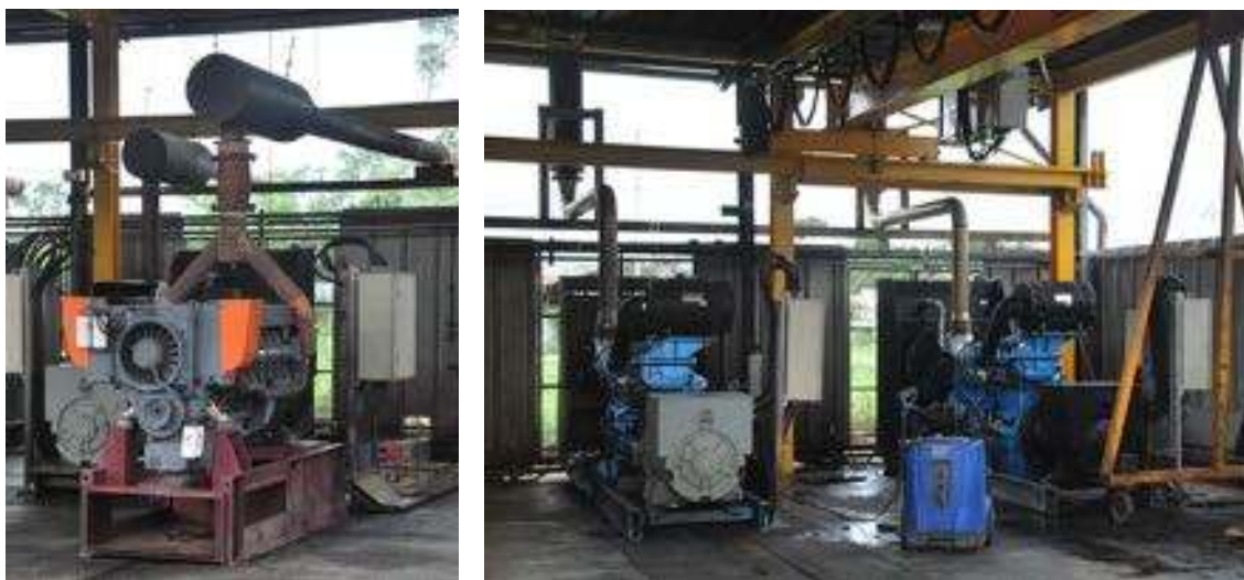
Vue de la salle des machines
