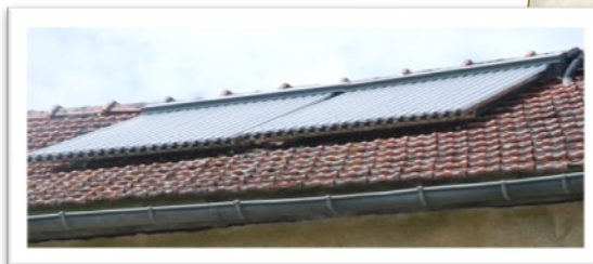
Le chauffe eau solaire en appoint pour l'eau chaude sanitaire
