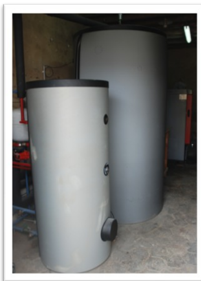
Le ballon d'eau chaude sanitaire (300 l) devant le ballon tampon (1400l) chaude sanitaire
