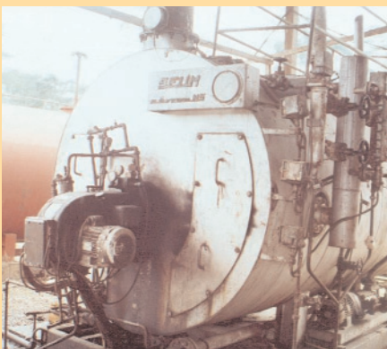
Chaudière à fuel pour la cuisson des noix à la SDAI
