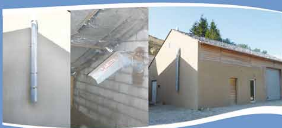
Bouches extérieure et intérieure de remplissage du silo
